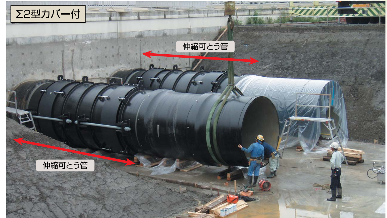
埼玉県内浄水施設
