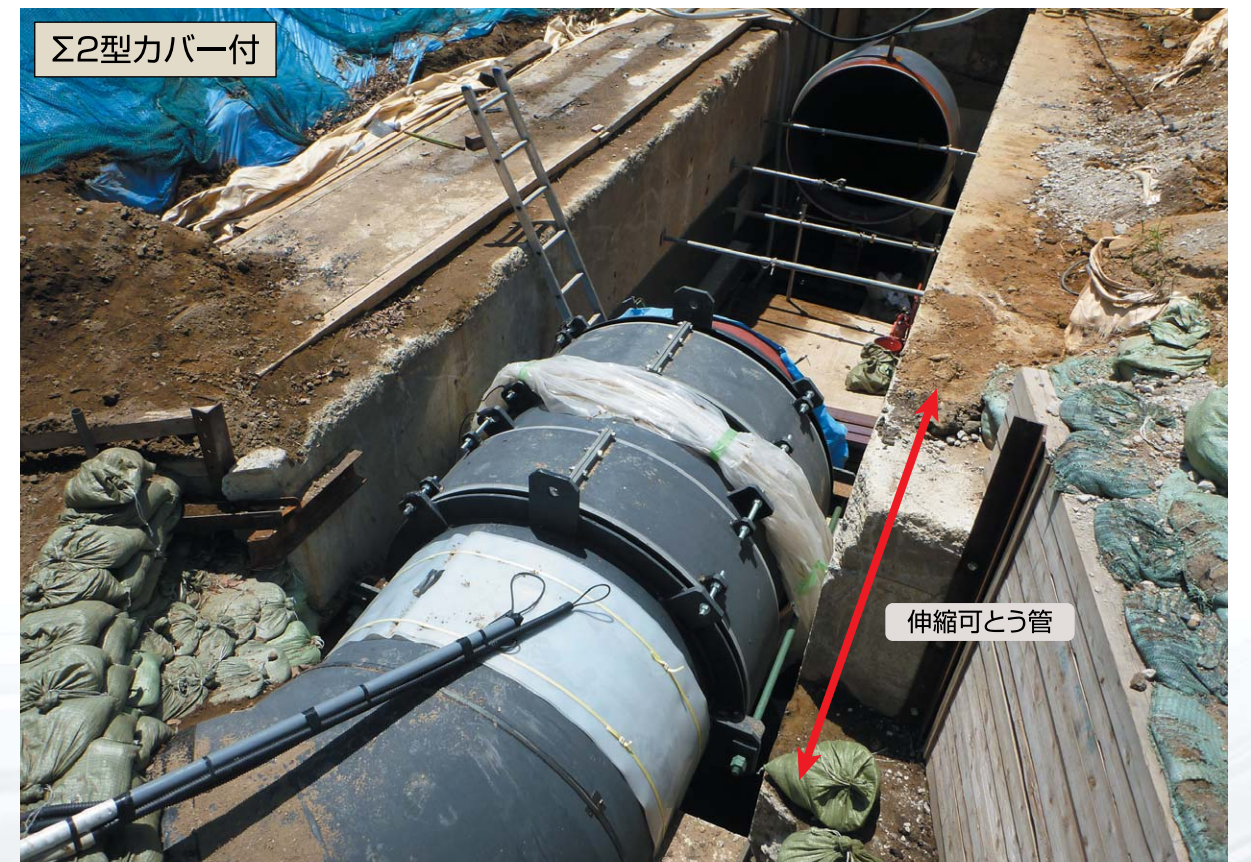
千葉県内浄水施設
